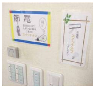
出入口のスイッチ近くに節電 POP を設置しています
