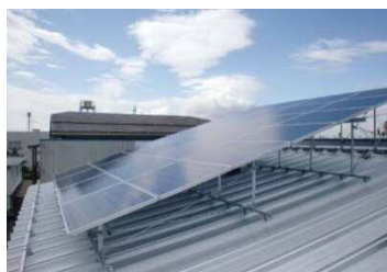
本社の屋上に太陽光パネルを設置しています
