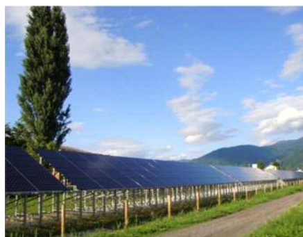
太陽光発電所
