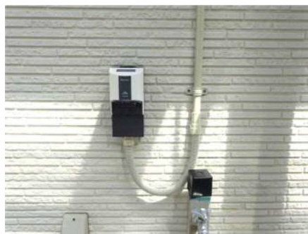
電気自動車充電設備
